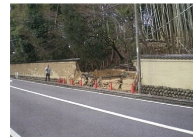
塀の倒壊(平成22年当時)
